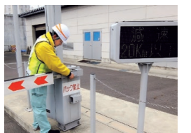
高速道路通信設備保守
